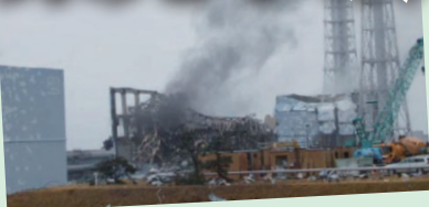
煙をあげる福島第1原発3号機 =3月21日午後4時10分（東京電力撮影）
